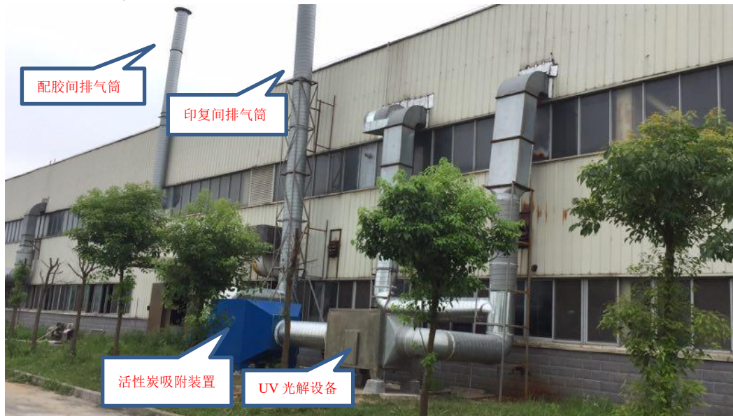
废气处理设施
