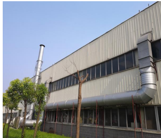
建材涂布间废气处理设施
