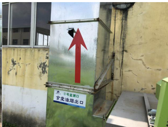
食堂油烟排气筒
